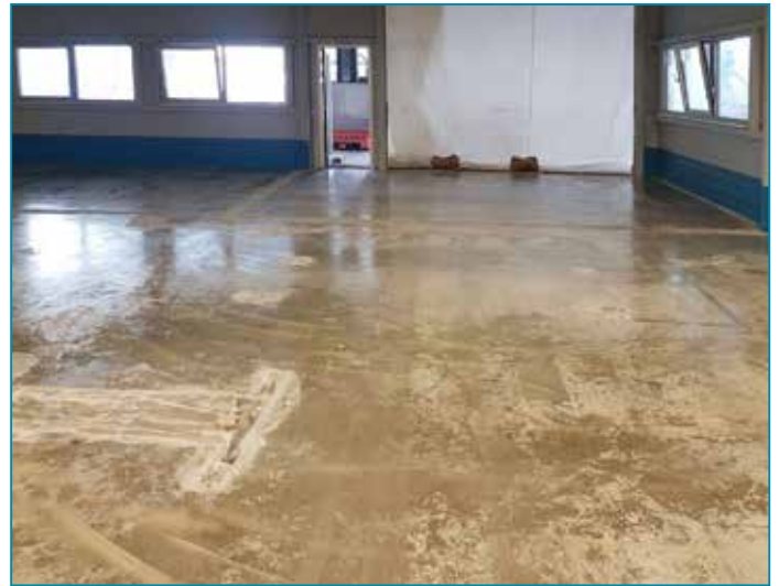
Grundierte, ausgeglichene Fläche | Primed, evened out surface
