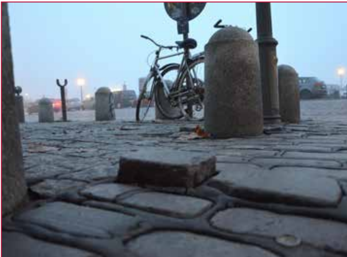
Gefährliche Pflasterung vor der Sanierung Dangerous paving stones before repair
