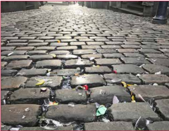
Vorher: Müll und gefährliche Scherben in den Fugen
